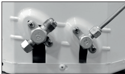
FIG. 42 - CONEXÃO DA LINHA DE EXPANSÃO DA UNIDADE CONDENSADORA
